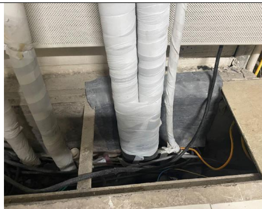
(机房线缆沟外侧)
