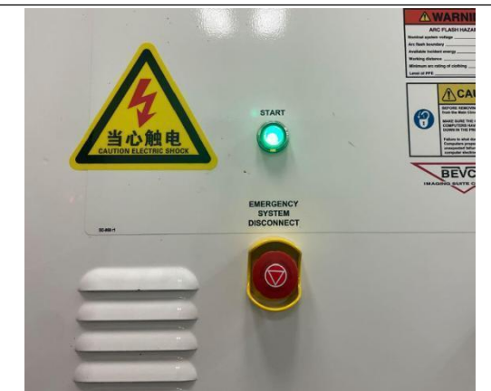
(配电柜急停按钮)
