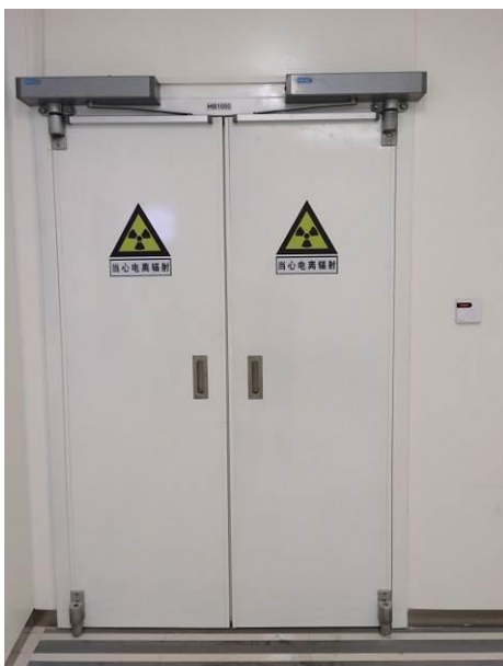
图4-2 控制区和监督区出入口的门禁系统
