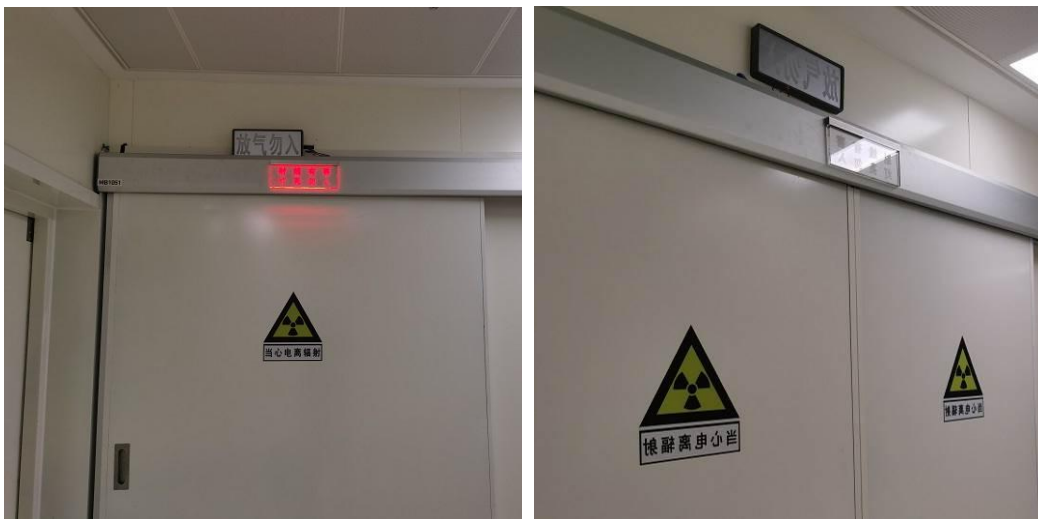
图 4-1 显像室外电离辐射警告标志及工作状态指示灯
