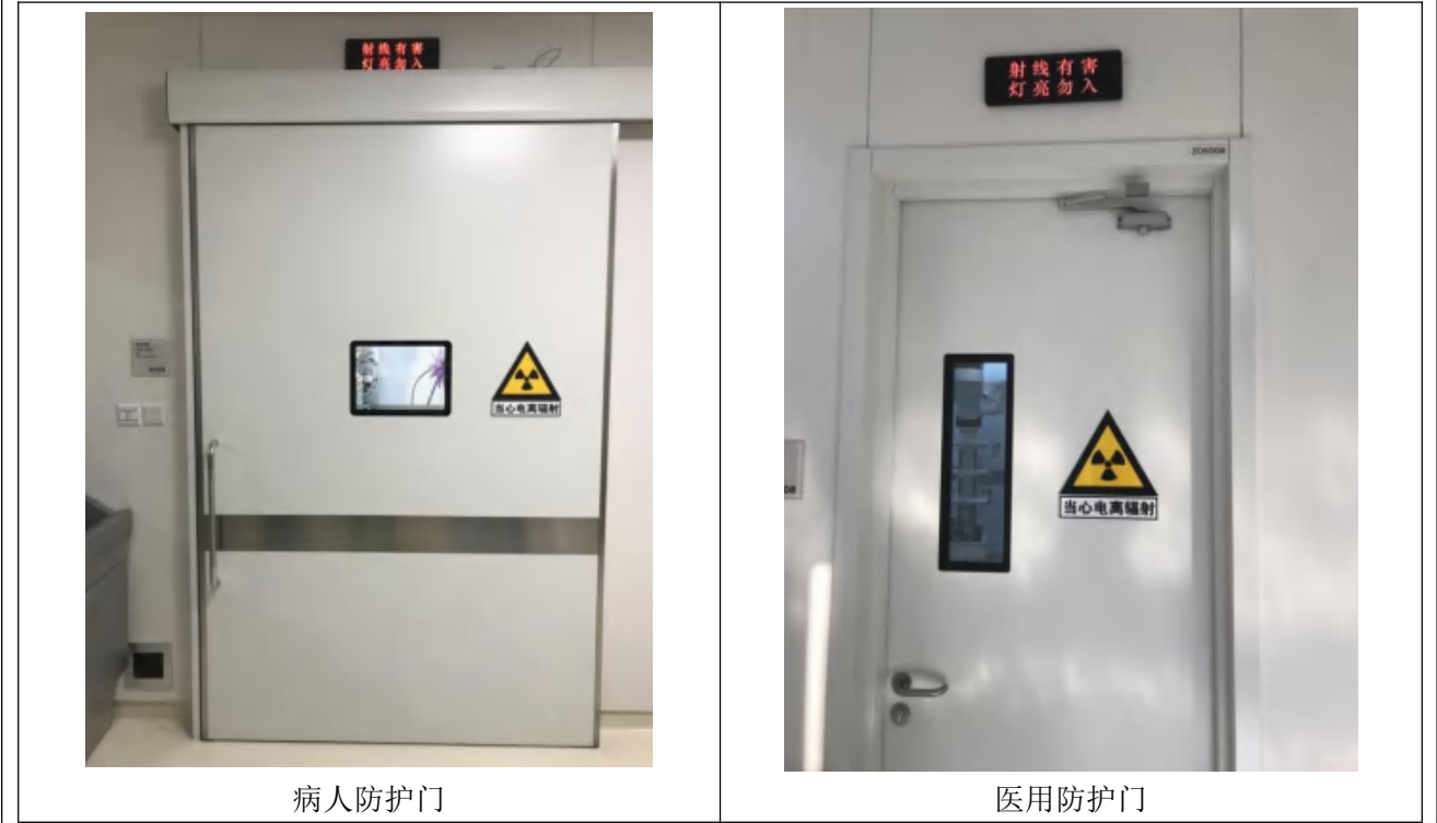
图 3.1 工作场所现场防护设施照片
